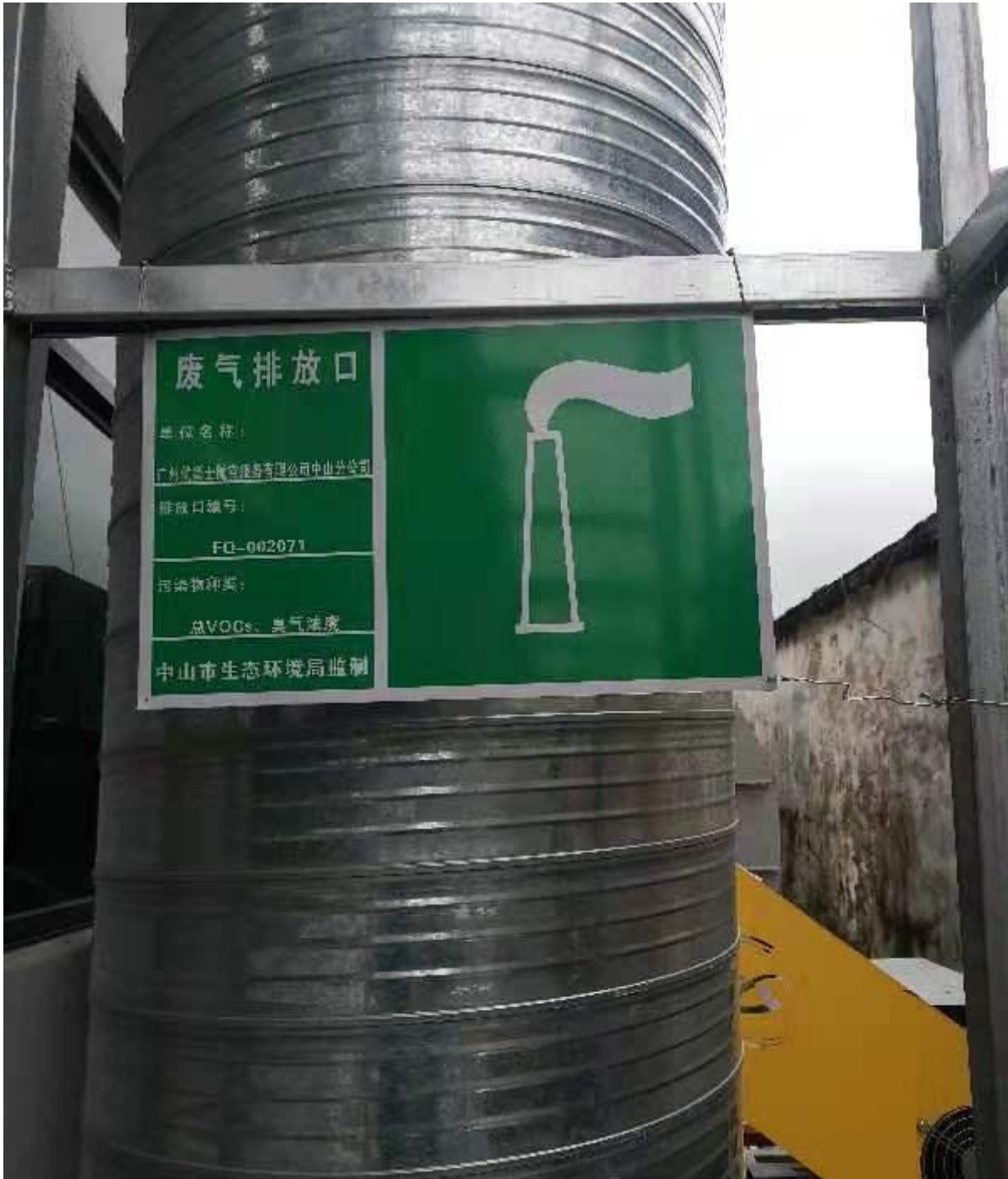
废气排放口 FQ-002071
