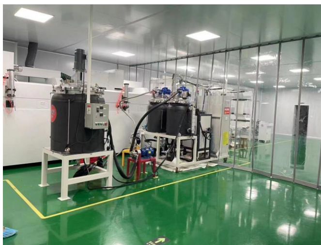
图 3-3.2 现场发泡机照片
