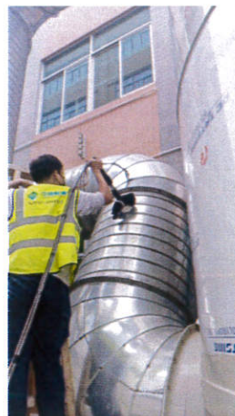
搅拌、倾倒、压料、投料、称料工序废气 处理前采样口
