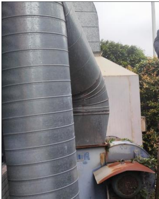
图 1 废气治理设施
