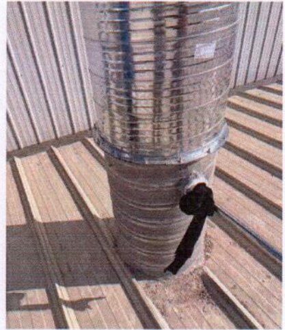
木工打磨工序废气排放口 (DA002)
