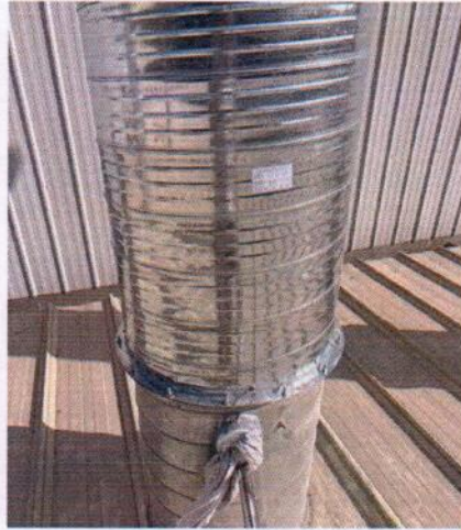
木工打磨工序废气排放口 (DA001)
