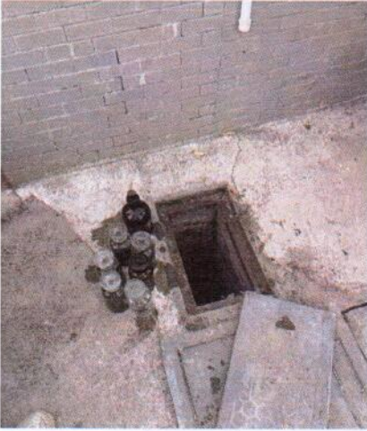
生活污水排放口
