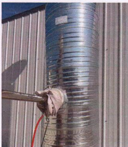
亚克力开料、机加工、粘合 及其晾干工序废气排放口 (DA006)
